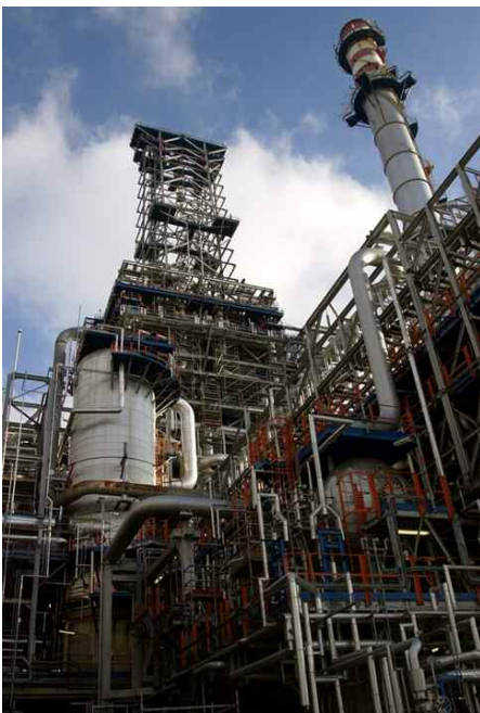
Planta de Coque.
