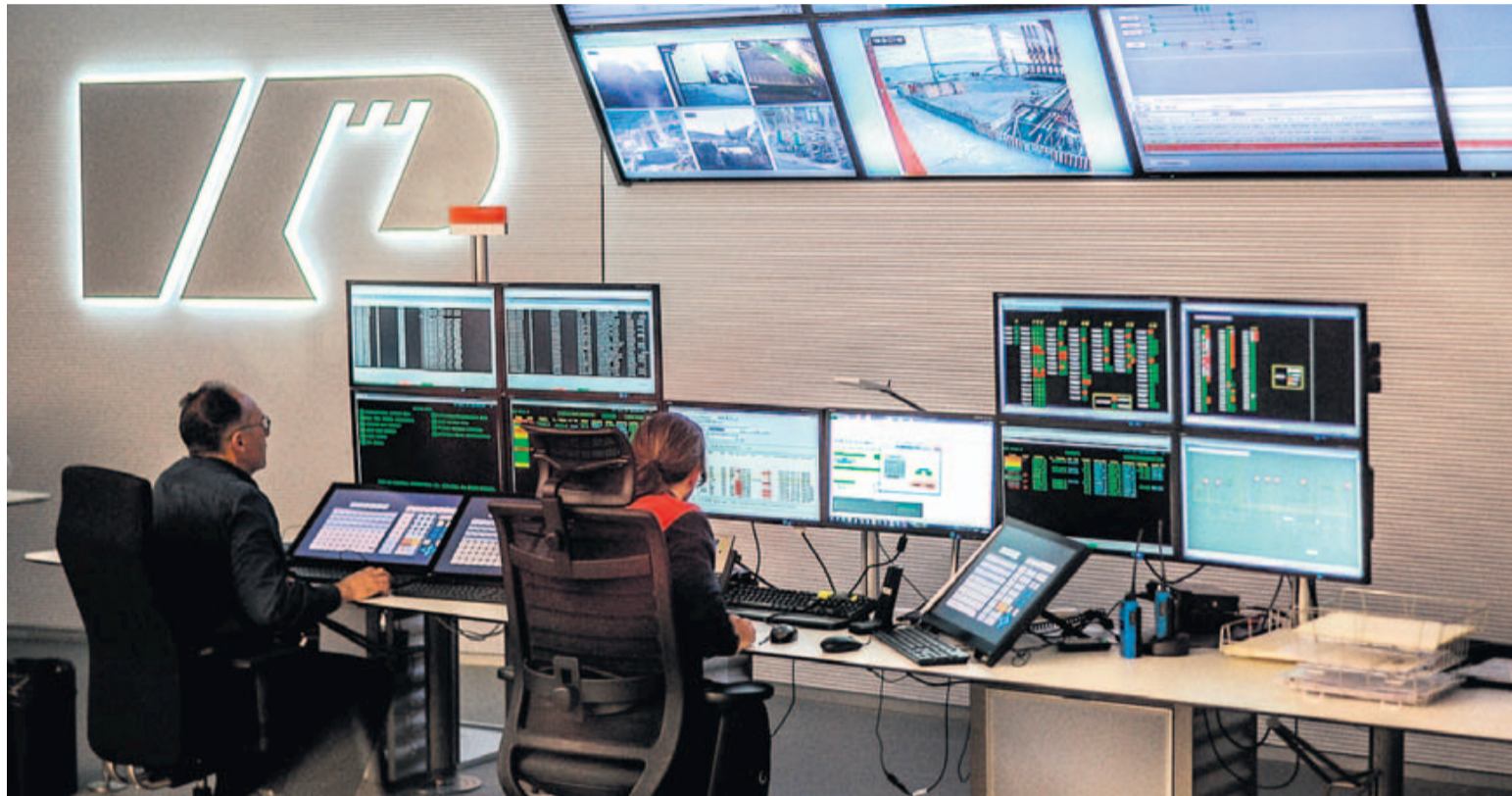
Petronor abrió ayer por primera vez a los medios su nueva sala de control, equipada para supervisar el funcionamiento de la planta. :: BORJA AGUDO
