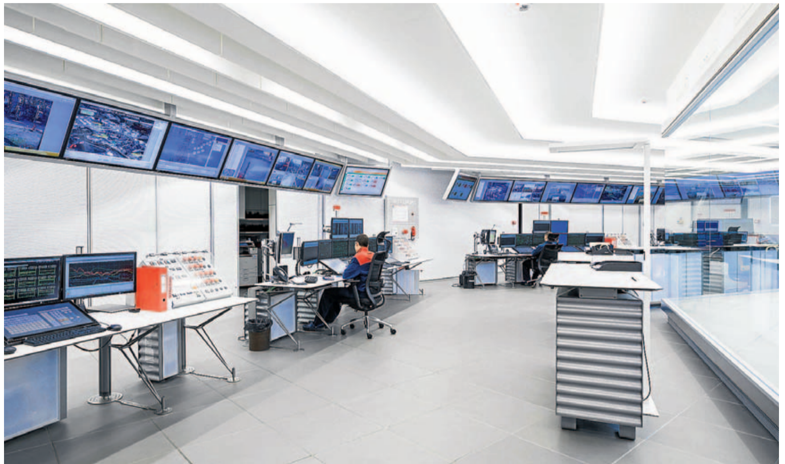
■ En la nueva sala de control los operadores reciben continuamente información para mejorar los procesos y prevenir averías.
