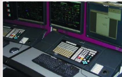
Consola de Operaciones de la Planta NF3
