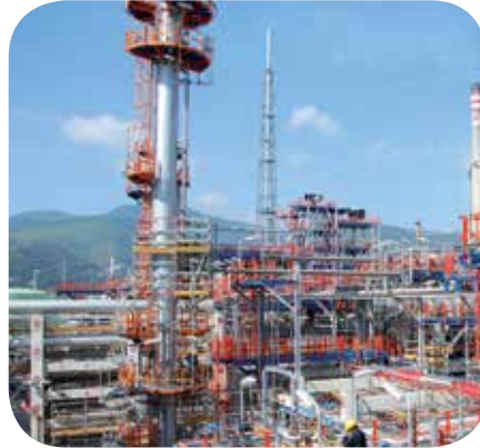
Vista de la Planta del URF.
