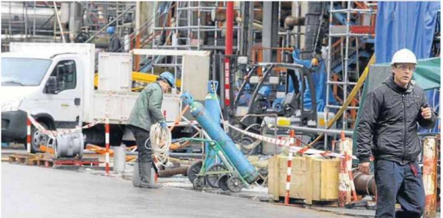
Más de cuarenta empresas contratistas han realizado los trabajos de mantenimiento de la Unidad de Conversión. Foto: Borja Guerrero
