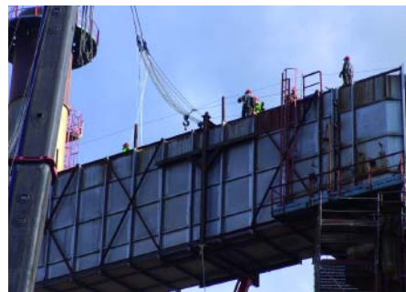
Ducto de humos.
