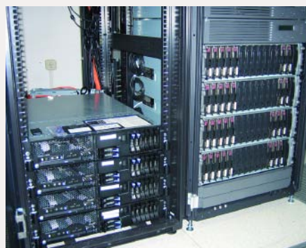
Rack de servidores y SAN de discos.
