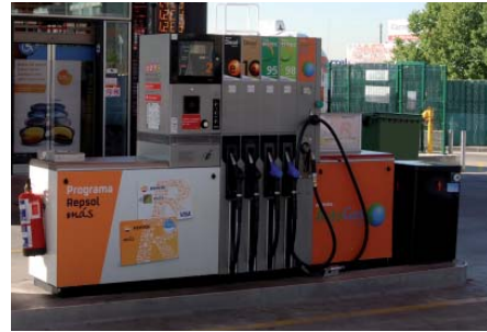
Suministro de gas.
