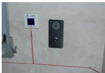
Pulsador de emergencia.
