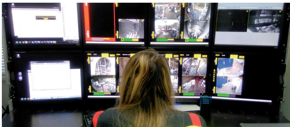
Centro de Control del sistema.
