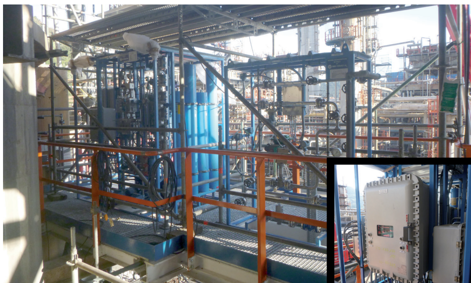
Nueva plataforma y centralita de control de válvulas tapón y unidad de purga instalada con el ADI 2760.
