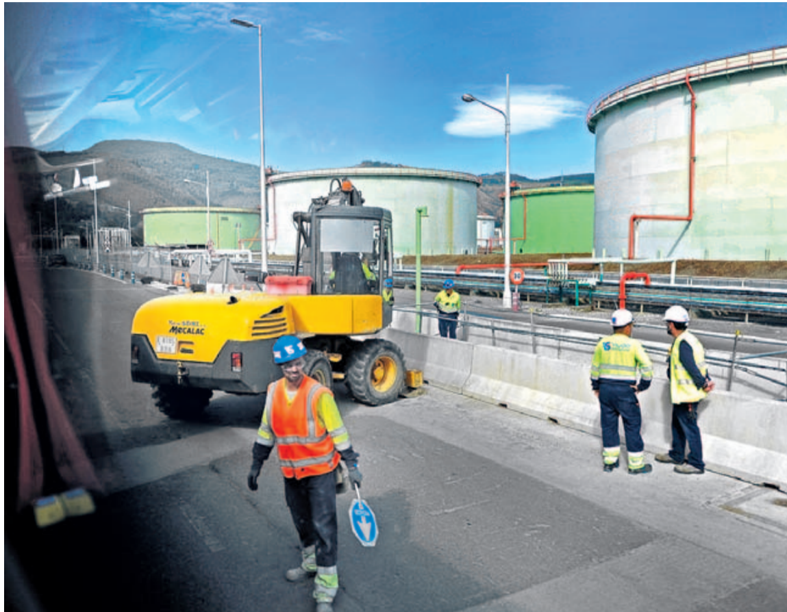
Los trabajos, que arrancaron el pasado 27 de mayo, permitirán a la planta ser más eficiente. :: F. GÓMEZ
