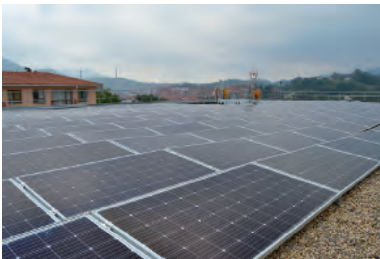
La planta fotovoltaica está en la cubierta del Centro de Formación Somorrostro.
